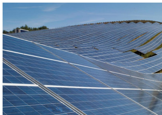
Foto 3: Painéis fotovoltaicos que acompanham a morfologia do terreno
