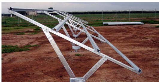
Foto 1: Mesa de suporte de painéis fotovoltaicos (fixa ao solo com recurso a parafuso) com 3 strings
